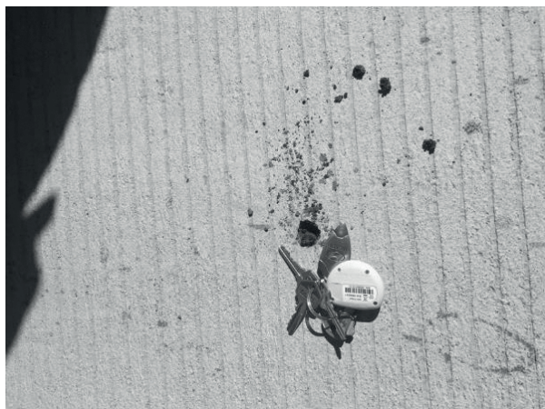
Figura 502.11 Estallido (popouts) en pavimento
