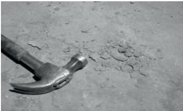
Figura 502.09 Desintegración superficial en pavimento
